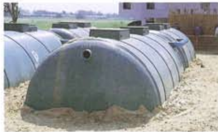
ติดตั้งครึ่งจอย (HALF TANK) : ตลาดไท ๓, ๓๒
